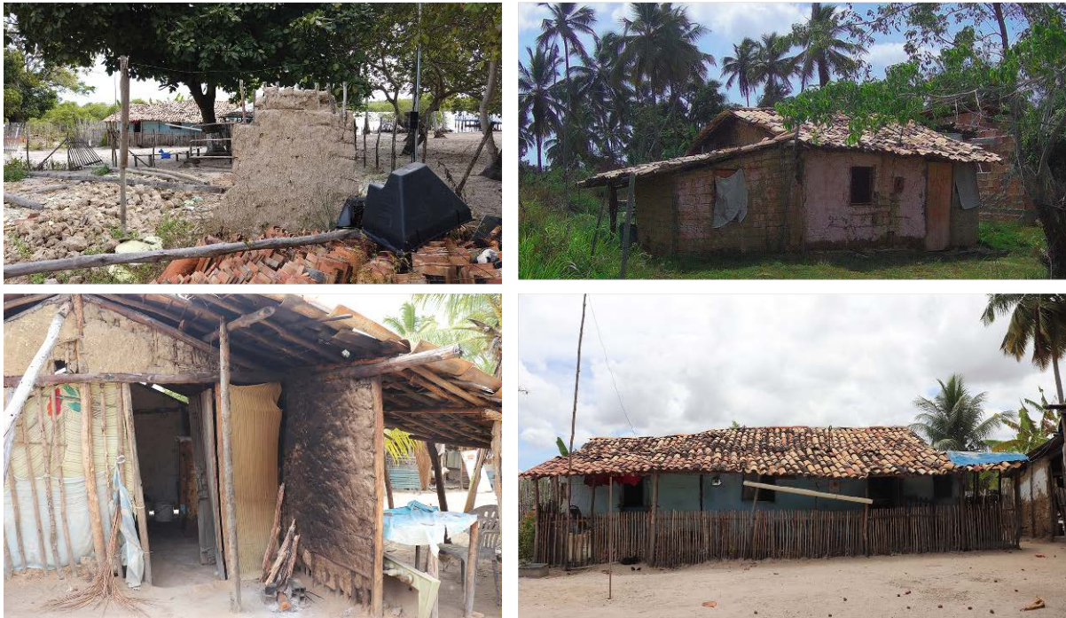
Figura 4. Residências em taipa de mão em destruição e/ou condições precárias (Andrade, 2020)
