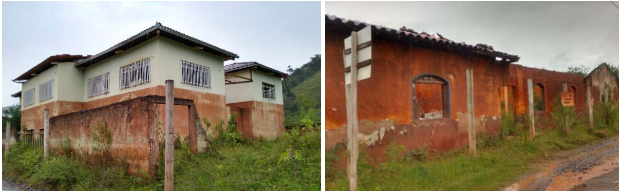
Figura 5. Remanescentes de construções convencionais em Paracatu de Baixo, nas quais se observa a altura que a lama de rejeitos atingiu as edificações.
