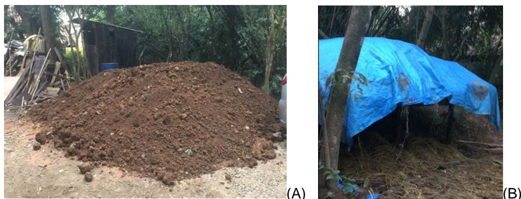
Figura 11 – (A) O volume de dois caminhões de terra, recém chegados no canteiro (B) Estrutura suspensa feita para armazenar proteger a palha da umidade
