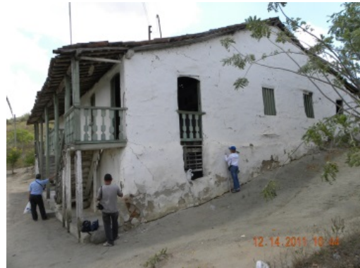
Figura 4. Estrutura de madeira apostada ao maciço de taipa para acessos ao pavimento residencial. Vista a partir do oeste. (Crédito: Ulisses Melo, 2011)
