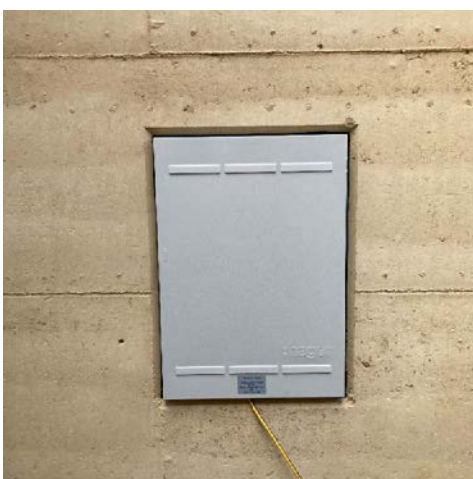
Figura 19 – Quadro de energia inserido na face externa da taipa
