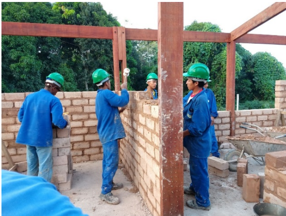
14 - Execução das alvenarias da Habitação, com a capacitação dos indígenas, aldeia Awá
