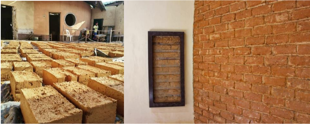
Figura 7 – Secagem dos tijolos e detalhe da parede da biblioteca de taipa de mão e adobe
