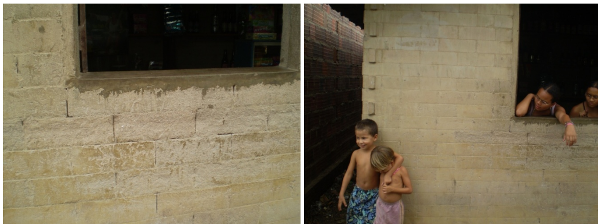
Figura 10 – Locais com desgaste abrasivo dos tijolos
