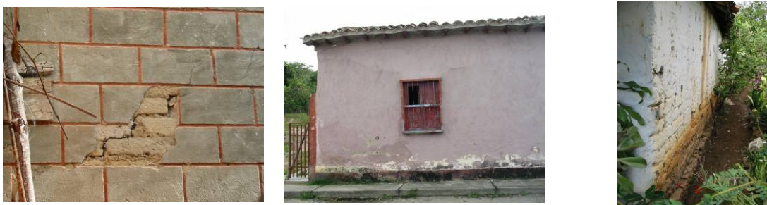
Figura 4 – Desprendimiento, eflorescencias y humedad localizada
