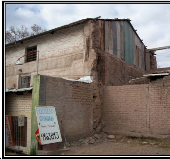
Figura 6 – Encuentro de muros norte y oeste
