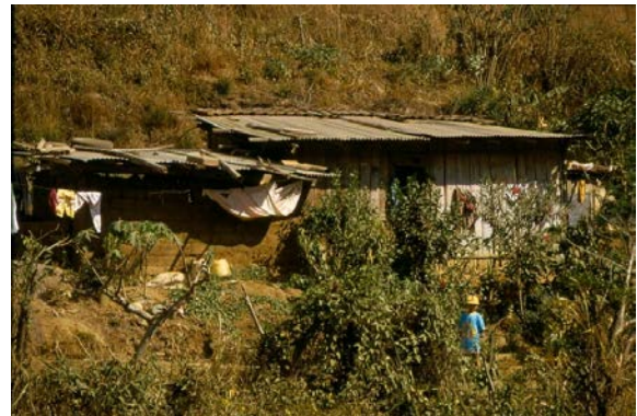
Figura 7 – Vivienda de madera. Infestada
