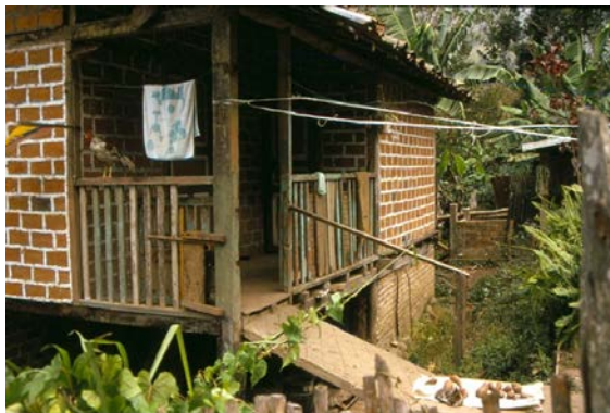
Figura 6 – Vivienda de ladrillo. Infestada
