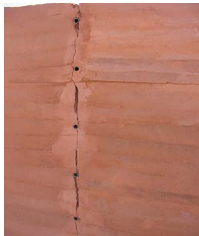
Figura 4 – Rachadura do painel 2
