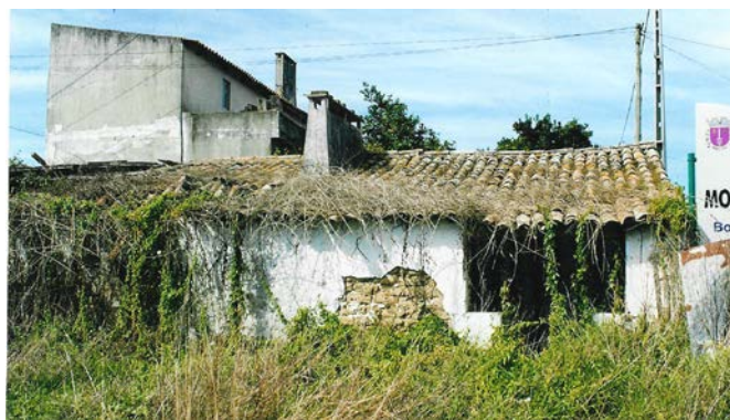
Figura 4 – Monte Real (Leiria). Casa em adobe com alpendre integrado, abandonada
