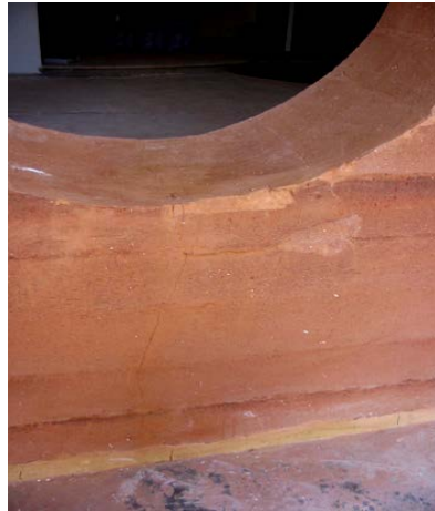
Figura 3 – Rachadura do painel 1
