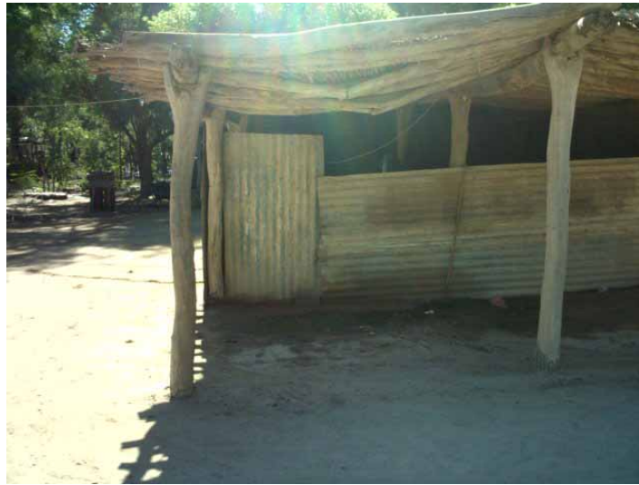
Figura 2 – Clasica roptura de las vigas secundaria abajo del cargo de la tierra
