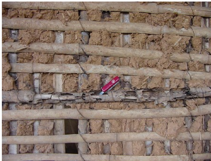
Figura 3 – Ataque de cupins-arbóreos em peça de madeira das paredes de taipa de mão
