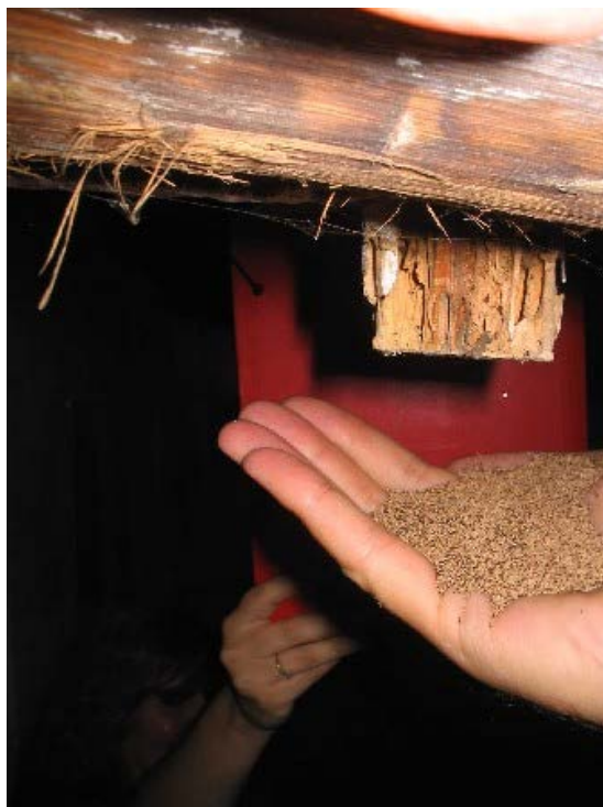
Figura 6 – Ataque intenso de cupins-de-madeira-seca em peça de madeira da parede de taipa; com destaque para a quantidade de resíduos produzidos por estes organismos
