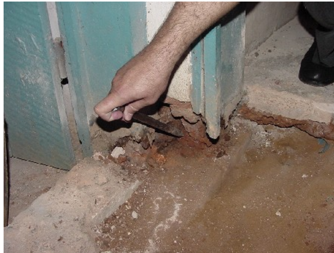
Figura 5 – Apodrecimento intenso na base de pilar de madeira
