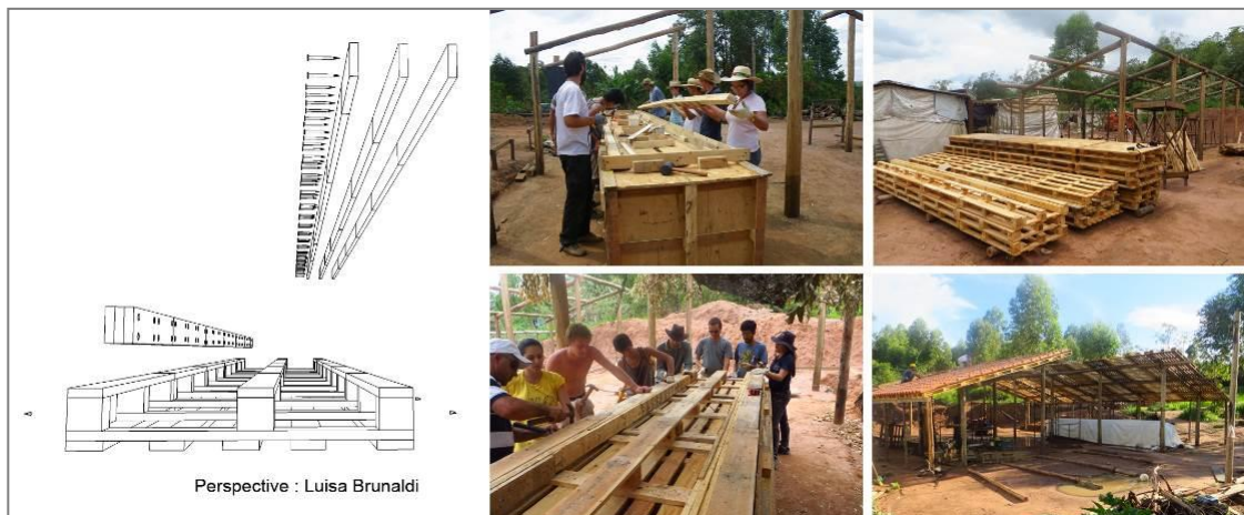
Figura 2 – perspectiva do painel pré-fabricado com as duas VLPs (uma montada e outra decomposta) que servirão para unir os paletes e estruturar os painéis; montagem dos painéis e colocação na casa.
