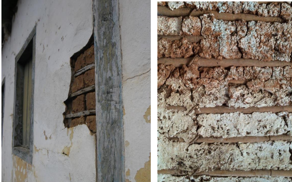
Figura 3 – Esquerda: aspecto da taipa de mão e pilar de madeira da estrutura autônoma principal. Direita: detalhe do pau a pique interno sem revestimento.
