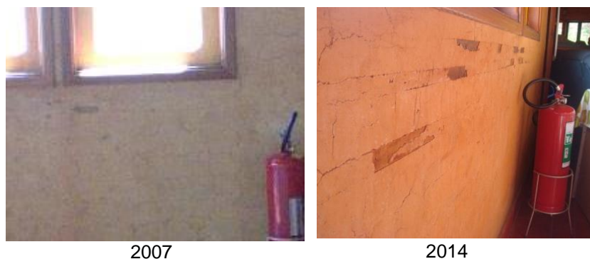
Figura 5 – Descolamento da argamassa na parede Nordeste do restaurante
