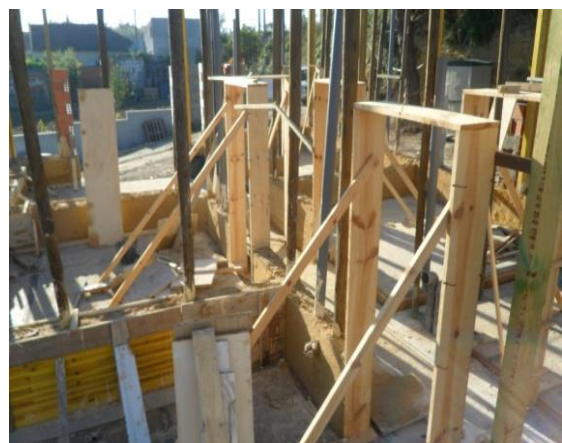
Imagem 3: Aros em madeira de portas interiores, tubagens para ventilação natural e reforços estruturais de madeira. Ao fundo à esquerda, reforço de vão de porta exterior em tijolo térmico e acústico.
