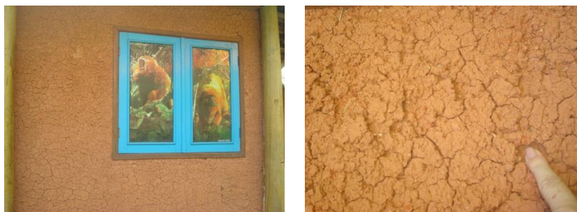
Figura 8 – Parede sem revestimento no bloco de administração, face Sudoeste.
