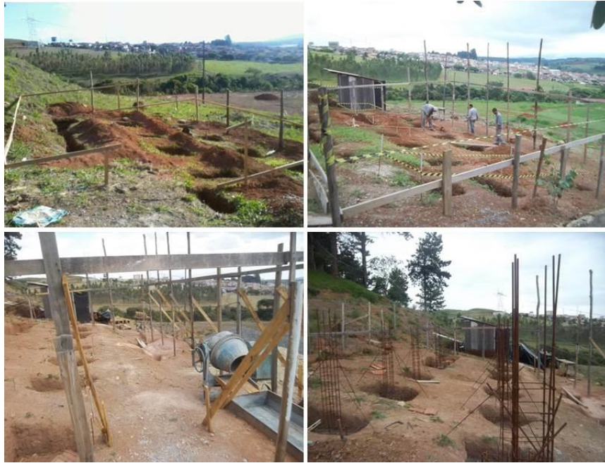
Figura 2 – Fotos do desenvolvimento da obra do Centro de Referência. Créditos: Marin, 2012 e Duarte, 2013.
