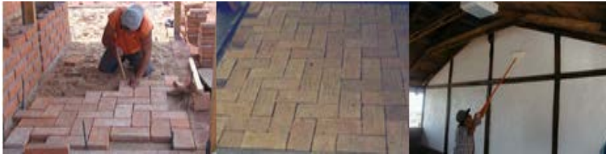
Figura 15. Piso de ladrillo sobre cama de arena, encalado de muros y aceite quemado a la madera expuesta
