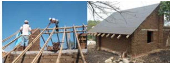
Figura 9. Fijación con varillas y tuercas de la estructura de cubierta a cadena perimetral y detalle del fieltro asfáltico sobre artesanado de madera
