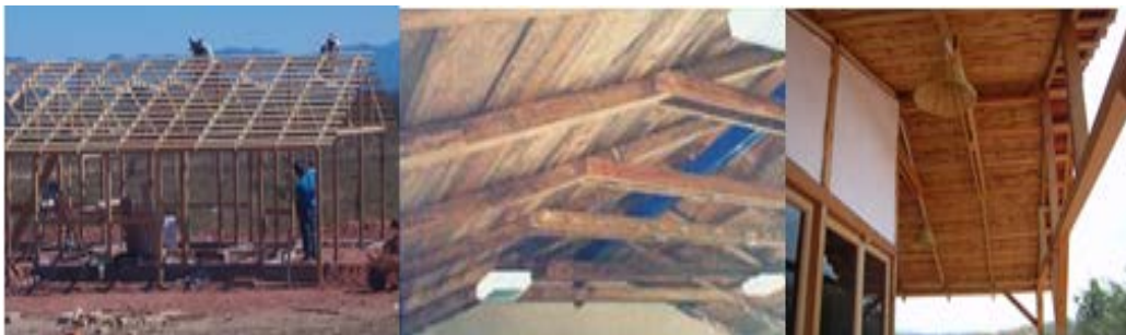
Figura 12. Estructura del sistema constructivo, muestras de las dos opciones de artesanado: con madera y mixto, madera y cañamaíz
