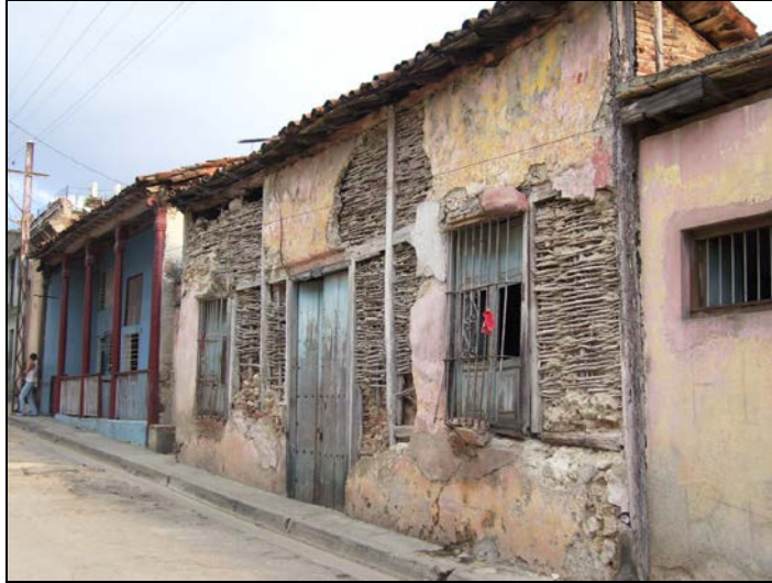
Figura 4. Fachada que muestra los elementos componentes de la tecnología en el tipo constructivo 1
