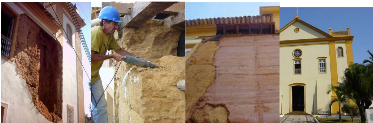
Figura 3. Restauración de tapial, Iglesia Matriz, Ciudad de Bananal, Brasil. Salmar-Tognon CT5 2012
