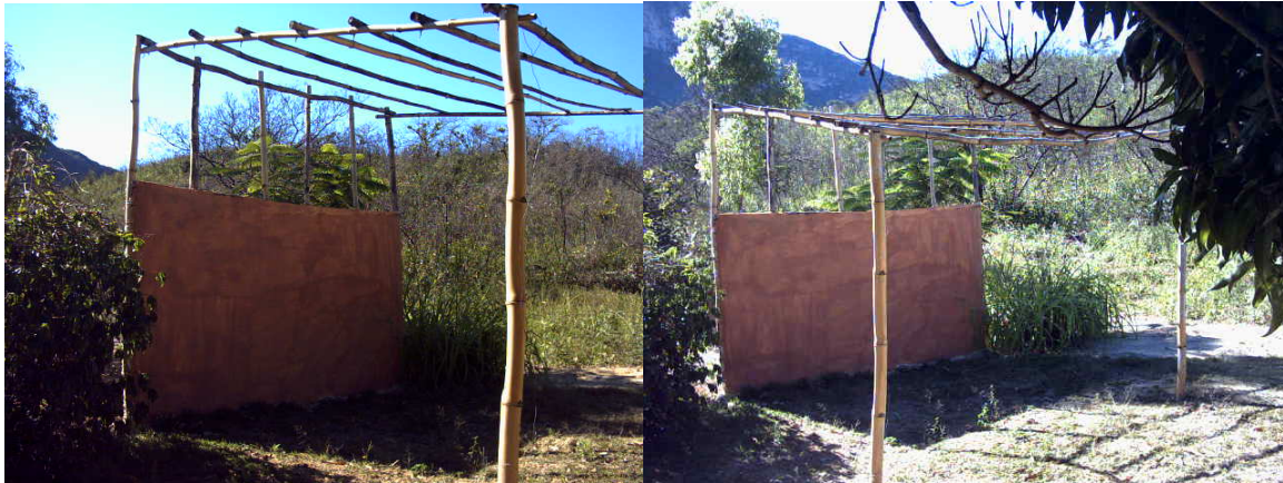
Figura 7. Aspecto do painel protótipo após 3 anos de executado. Fonte: autores
