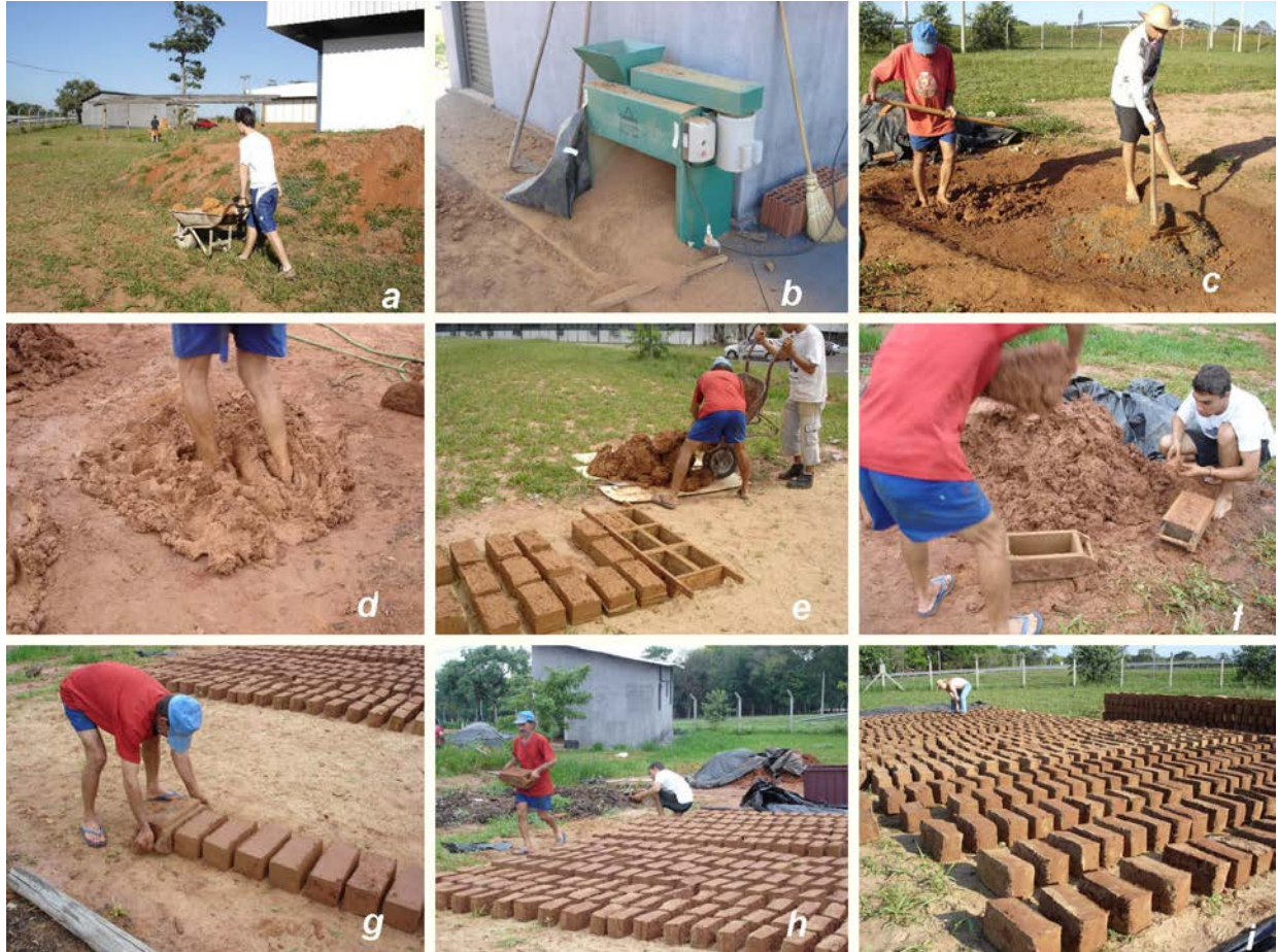
Figura 5 – Etapas da produção dos adobes: transporte do solo, entre o depósito e o local de destorroamento (a); destorroador mecânico de solos (b); mistura do solo com biomassa triturada (c); amassamento do barro com os pés (d); moldagem em forma, sem fundo, para 6 adobes (e); moldagem em forma individual, com fundo (f, g, h); e, etapa de secagem dos adobes (i).
