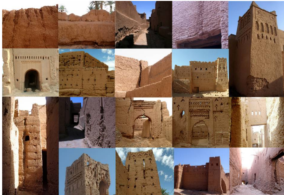
Figura 11 – As patologias (Créditos: Baglioni, 2009; Mecca, 2007; CERKAS, 2005)
