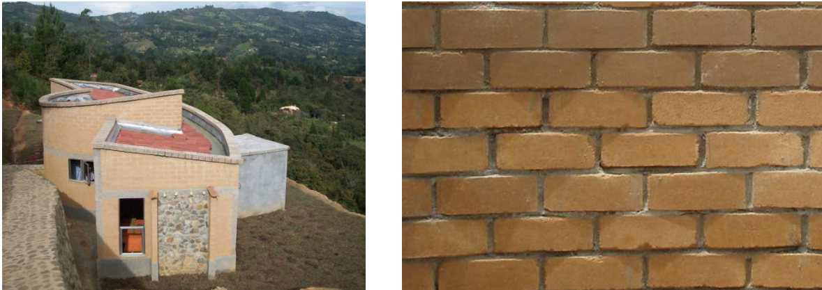
Figura 1. Vivienda construida en bloque de tierra comprimida (BTC) y detalle de muro interno sin acabados
