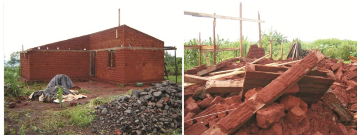
Figura 4. Casa de adobe antes e após colapso (Fonte: HABIS, 2008)
