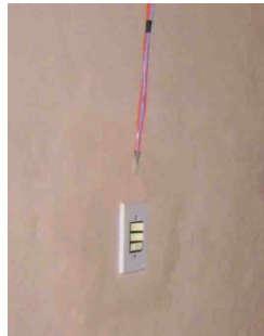
Figura 5 – Instalação elétrica semi-embutida na parede (crédito: Paiva, 2009)
