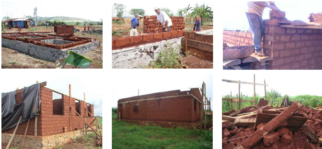
Figura 8 – Etapas de construção da casa com paredes autoportantes de adobe e do desmoronamento de uma delas (acervo HABIS).
