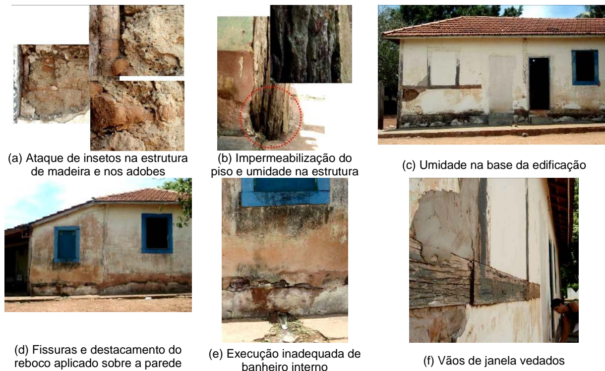
Figura 4. Patologias da Casa Colonial, Miranda, 2009 (créditos: Zanoni)
